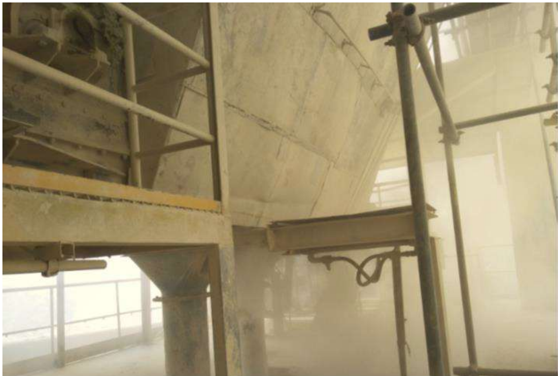
Gambar 1 Kondisi tidak aman di area Under GCT
