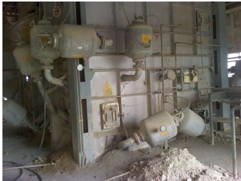
Gambar.1 Kondisi Dinding Kiln Inlet
