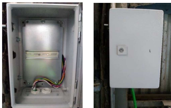
Gambar. 5 Panel lokal untuk control valve 562-IJ1
