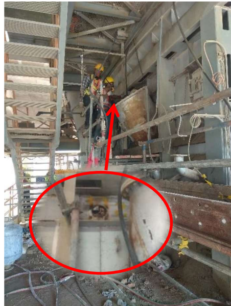
Gambar.11 Letak Air blaster sisi Barat
