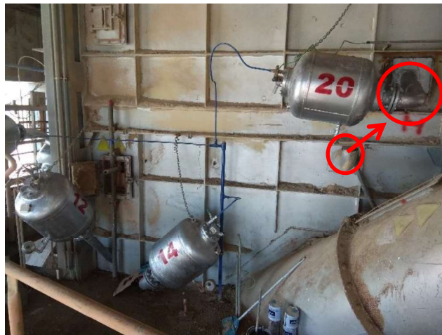
Gambar.12 Letak Air blaster sisi Timur
