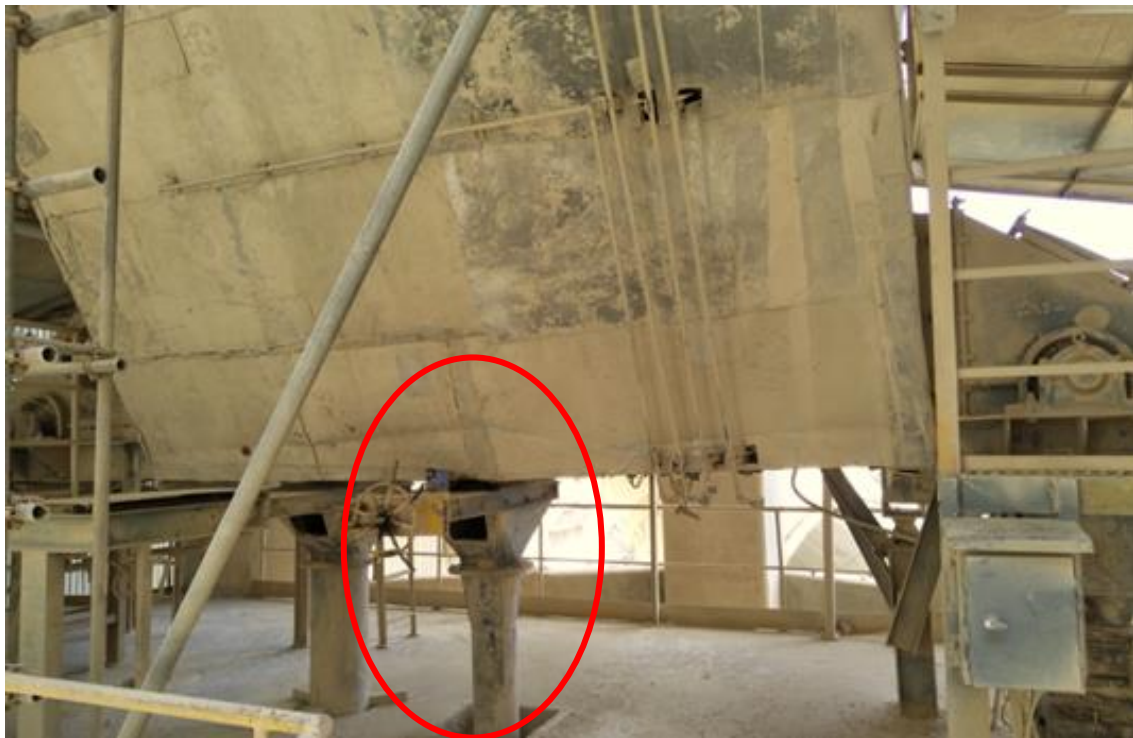
Gambar 2 Lokasi pembuka damper yang sangat dekat dengan equipment
