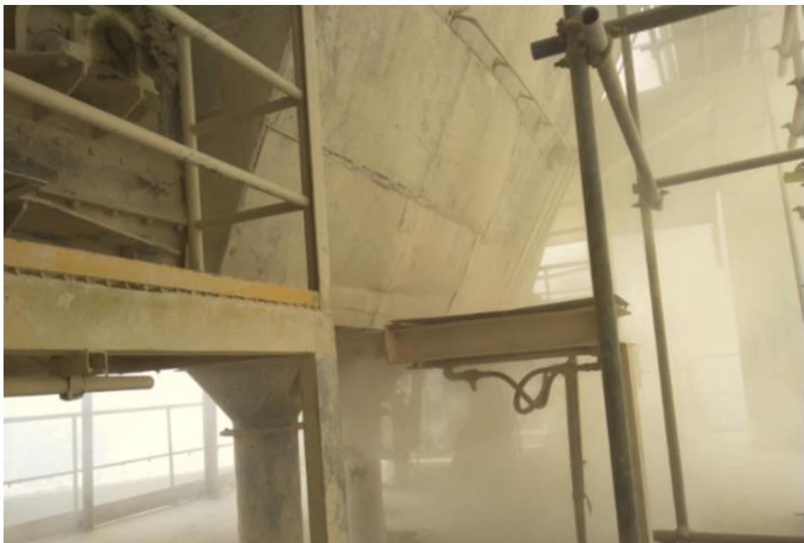
Gambar 1 Kondisi tidak aman di area Under GCT
