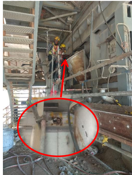
Gambar.11 Letak Air blaster sisi Barat
