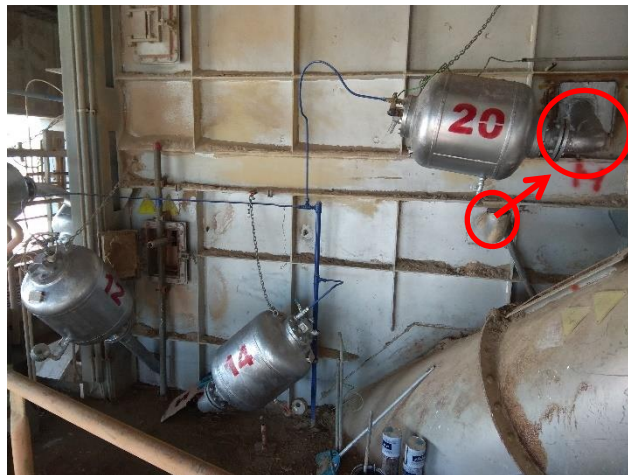
Gambar.12 Letak Air blaster sisi Timur
