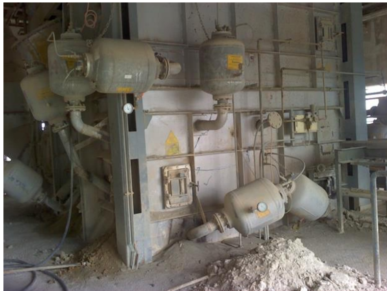
Gambar.1 Kondisi Dinding Kiln Inlet
